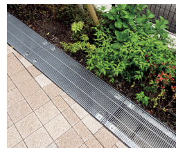
スチール製グレーチング
