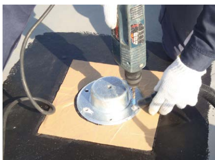
②スラブコンクリートに穴を開け、金具本体をアンカープラグ固定(6ヶ所)
