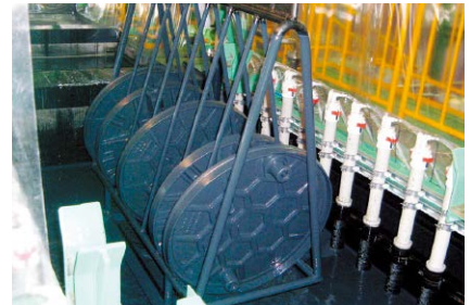
カチオン電着塗装設備
