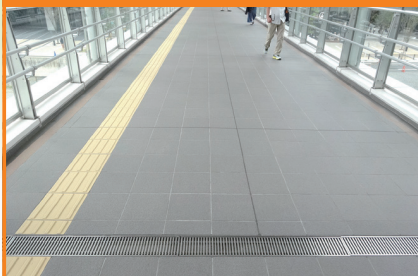
ステンレス製グレーチング
