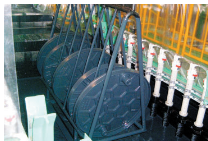
カチオン電着塗装設備
