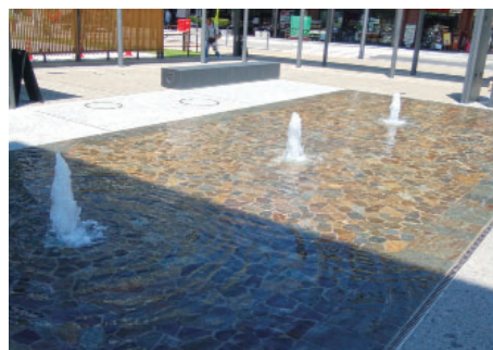
噴水吹き出し口 ステンレス製 舗装材充填蓋
