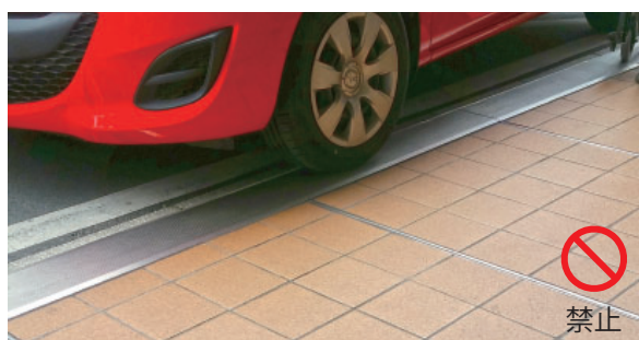
免震エキスパンションジョイントの可動部に駐車した良くない例
