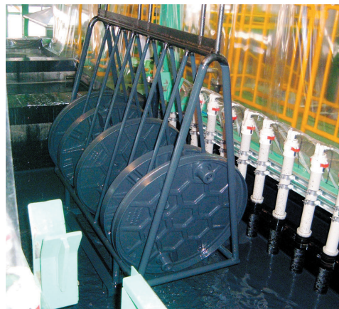
カチオン電着塗装設備
