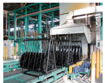
カチオン電着塗装設備
